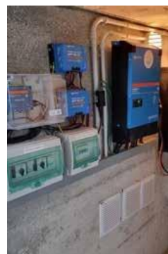
Impianto fotovoltaico, completo di sistema di accumulo e integrazione con gruppo elettrogeno gestito da remoto.
